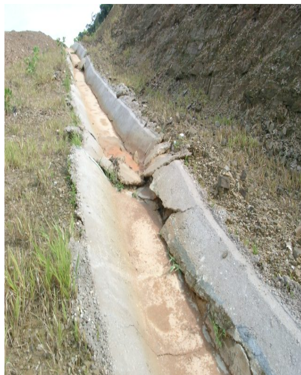
(d) Surface Crack on Slope Drain
